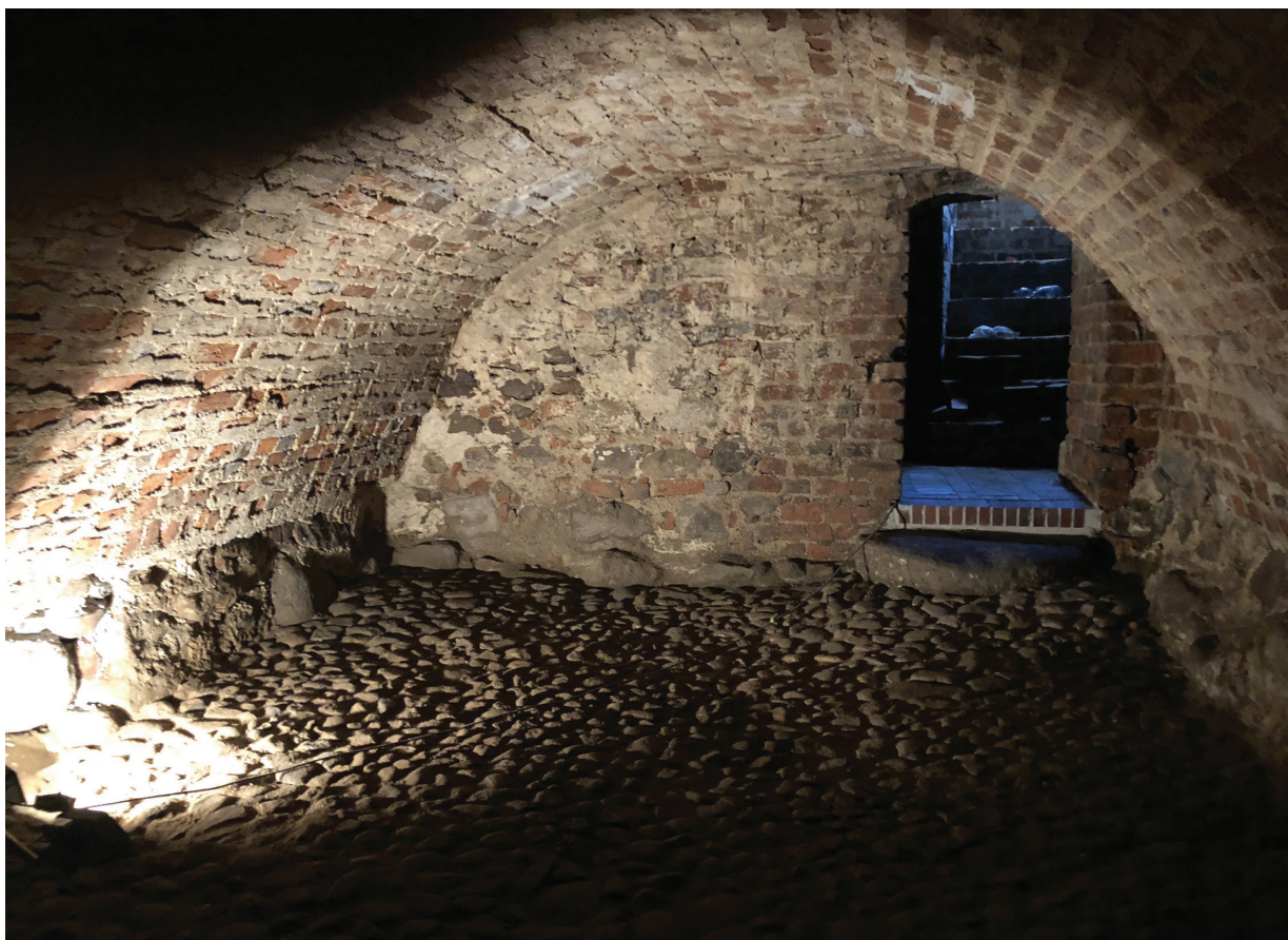
Il. 5. Szprotawa, dawny klasztor magdalenek, piwnica wschodnia, wnętrze i bruk z eratyków, stan po pracach (fot. A. Legendziewicz)
