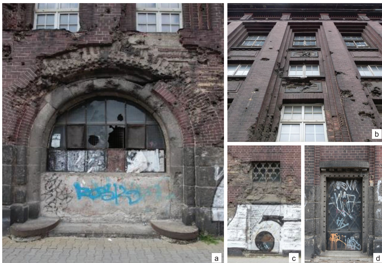
Il. 8. Fragmenty licowanej ceramiką elewacji południowej magazynu mąki z widocznymi uszkodzeniami: a) brama przejazdowa zwieńczona oblicowanym ceramiką łukiem o konstrukcji żelbetowej, b) widok od dołu na fragmenty fasady z osiami okiennymi ujętymi w płytke, schodkowo ukształtowane ceramiczne wnęki, c) kamienny portal wejścia z zabytkową ślusarką drzwiową i żeliwną kratą w nadświetlu, d) kamienny portal wejścia na klatkę schodową z zabytkową ślusarką drzwiową (fot. P. Kirschke, M. Lamber, 2016)
