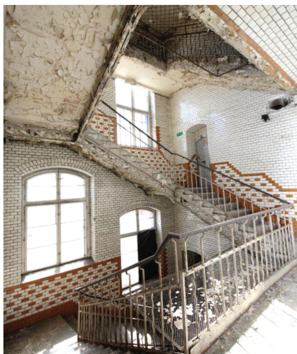
Il. 14. Widok wschodniej klatki schodowej K4 z poziomu spocznika na 2. piętrze. Zachowane stalowe kratownice tworzące policzki i żelbetowe płyty schodów, dwubarwne, ceramiczne lico ścian oraz stalowe balustrady (fot. M. Lamber, 2017)
