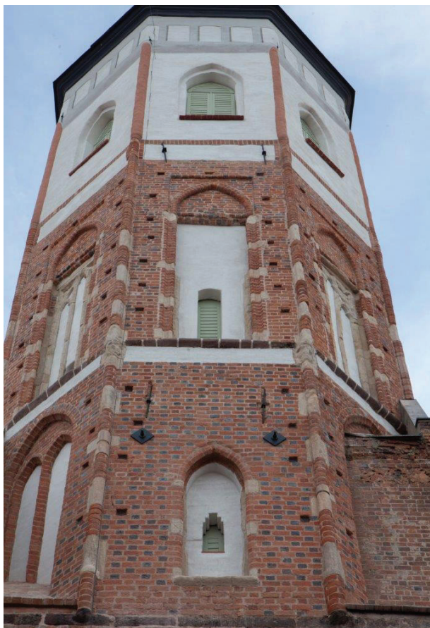
Il. 8. Koźuchów, wieża kościoła pw. MB Gromnicznej, widok elewacji północnej po zakończeniu prac (fot. A. Legendziewicz)
