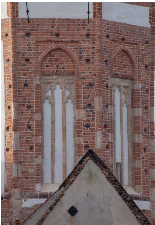
Il. 4. Kożuchów, wieża kościoła pw. MB Gromnicznej, fragment elewacji wschodniej z maswerkami okiennymi, stan po zakończeniu prac (fot. A. Legendziewicz)
